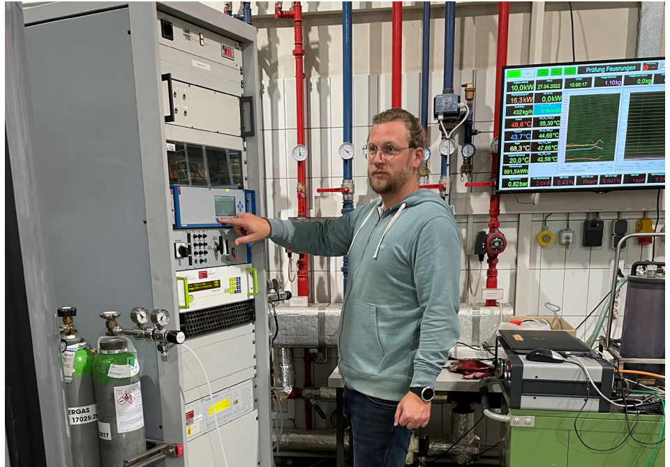
In der Kesselprüfstelle der BLT Wieselburg werden die Biomassekessel auf Herz und Nieren getestet.
