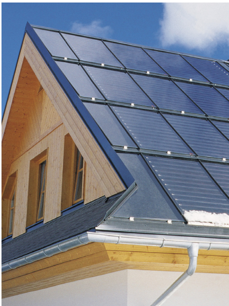
Abb. 6: Eine thermische Solaranlage kann im Sommer den Wärmebedarf decken. Foto: AEE Intec
